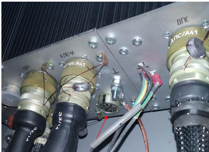
Рисунок Г.8 – Отсутствие заглушки или кабеля на соединителе CAN блока БЭЛ-УМ
