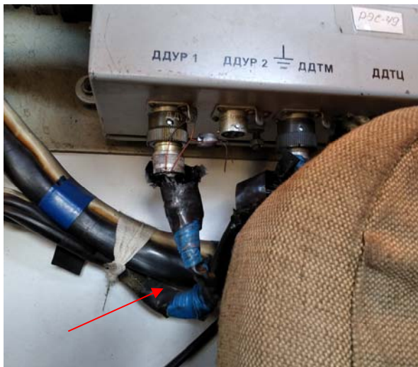
Рисунок Г.10 – Перегиб кабеля вследствие неправильного монтажа
